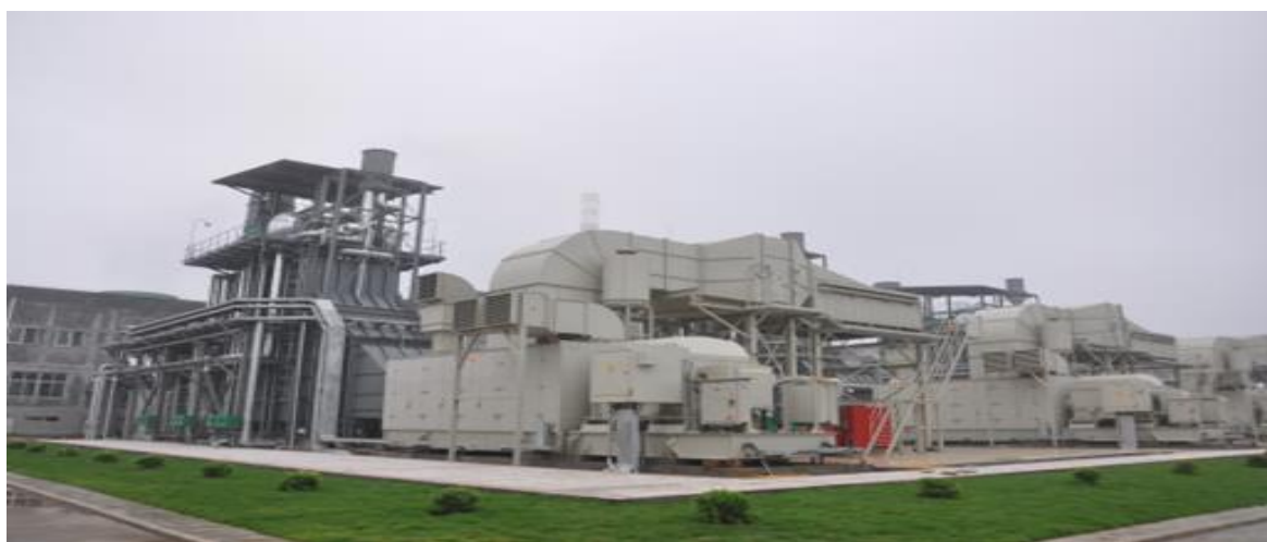
(图片所示：公司齐河工厂燃机装置)
