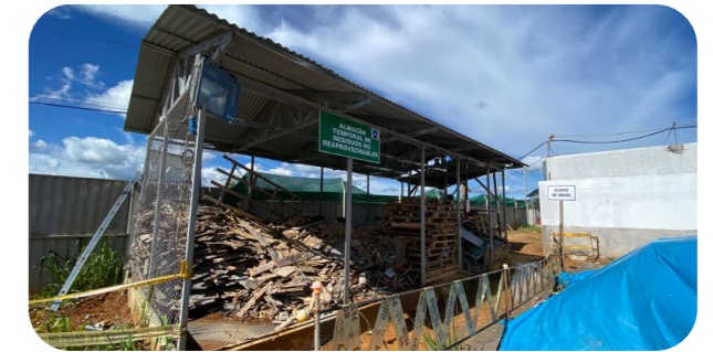
秘鲁胡宁省圣马丁医院项目设置建筑垃圾废料临时分类存放点
