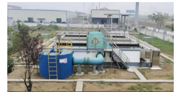
邳州市东区污水处理厂 TOT 项目
