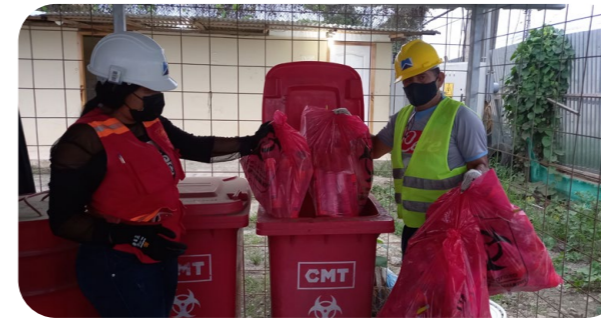
厄瓜多尔佩德纳斯医院项目施工过程中产生的危险废料 规范回收并交由当地政府统一处理
