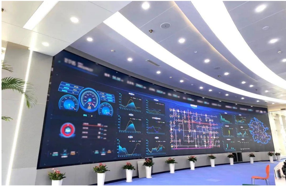
能源——国网某电力有限公司电力调度控制中心
