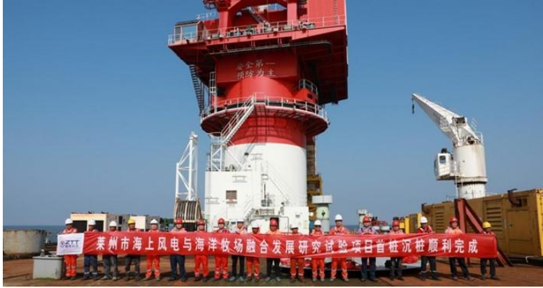
图 1-1: 莱州市海上风电与海洋牧场融合发展研究试验项目施工现场
