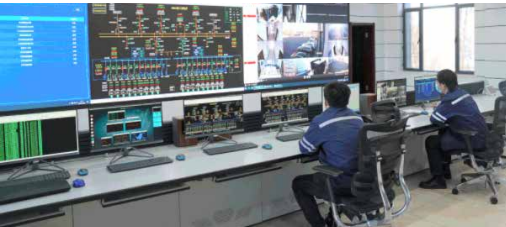
疫情期间保电人员坚守岗位做好防疫保供工作
