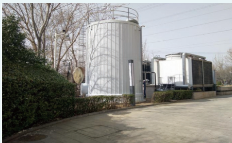
辦公樓蓄冷節能系統
