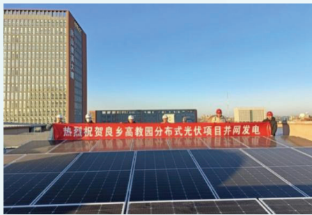
良鄉高教園區分佈式光伏項目
