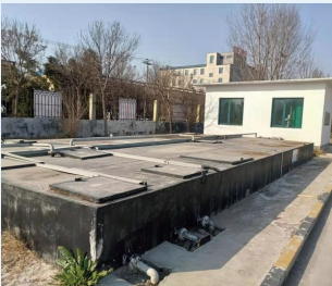
生活污水处理站
