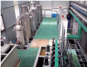
无锡瑞特(无锡工厂)废水零排放设备
