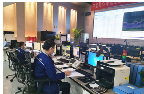
> 北京燃气运营调度中心 SCADA 监控系统
