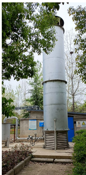
> 更换的新技术无风机抽排火炬
