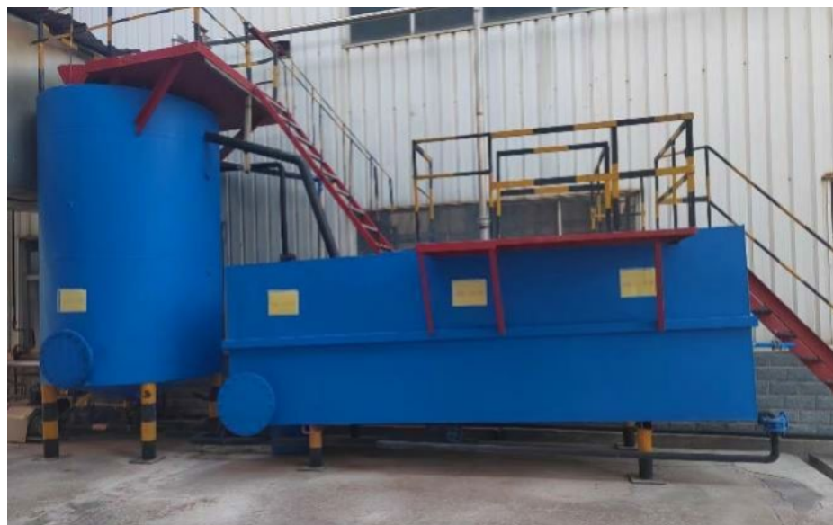
> 废硅藻土回收装置
