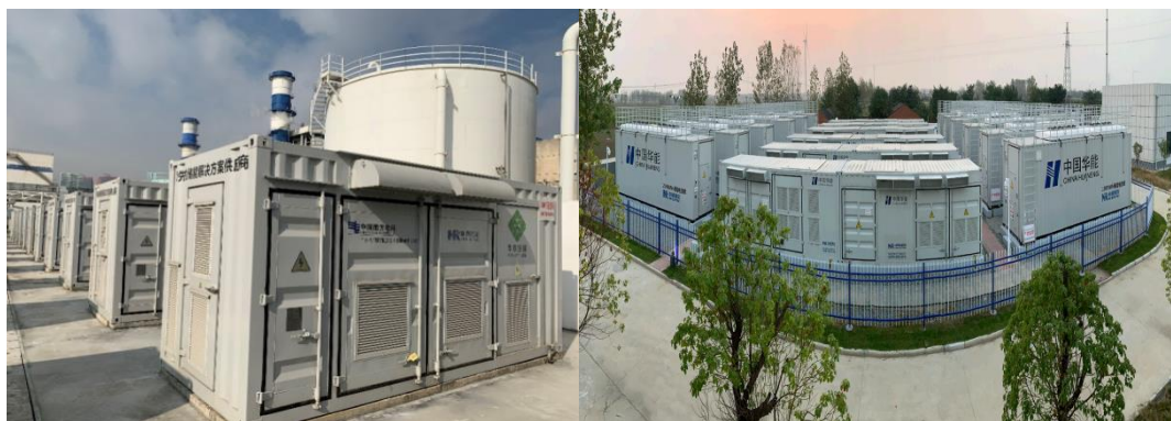
(储能工程项目现场图)
