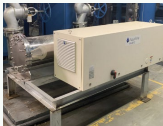
纯水 TOC 装置更新
