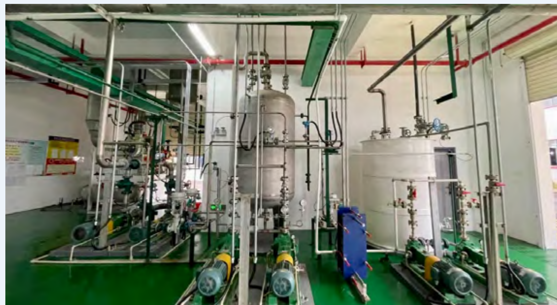
富远废水资源化回收利用车间氯化钙蒸发结晶系统
