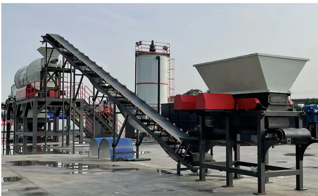
杭钢项目淋洗设备实景图
