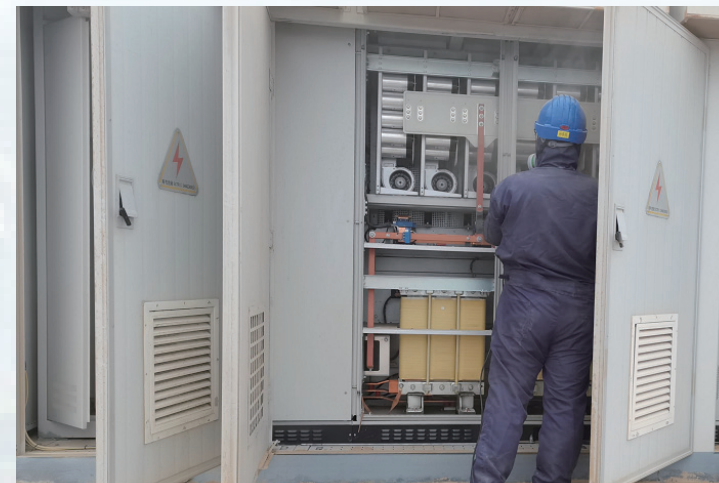
青海分公司格尔木检修中心逆变器维护保养
