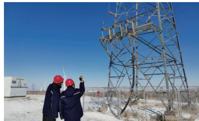
康保风电场巡检团队开展防寒防冻专项隐患排查工作
