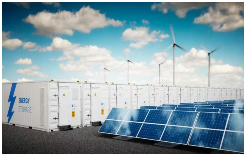
(以集装箱为载体的铅酸蓄电池储能系统, 图片源于 http://www.cableabc.com/ )
