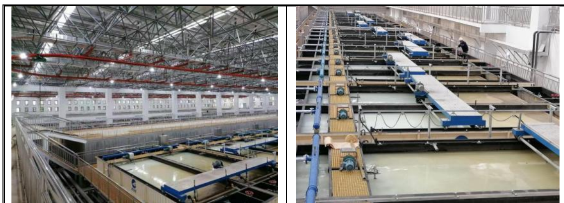
昆明市第七、八水质净化厂超极限除磷提标改造项目（现场实景）
