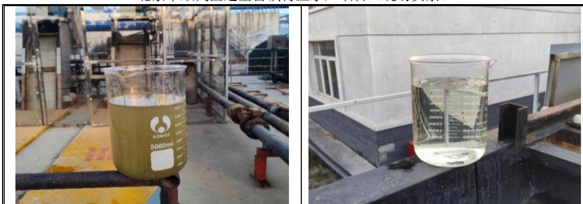
北京市顺义区赵全营镇再生水厂项目（水质前后对比图）
