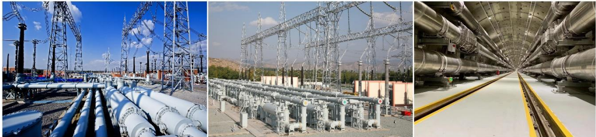
国内首套 1100kV GIS 产品应用于我国首条特高压示范工程—晋东南站
