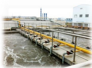
废水生化处理系统
