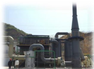
RTO废气焚烧系统 (蓄热式热力焚烧炉)
