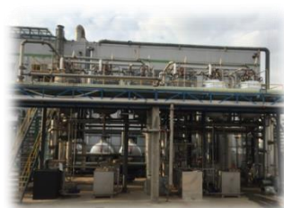
活性炭和碱液废气吸收系统
