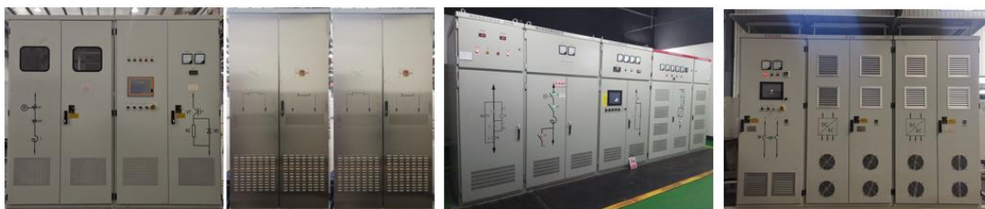
电阻耗能型再生制动能量吸收装置
