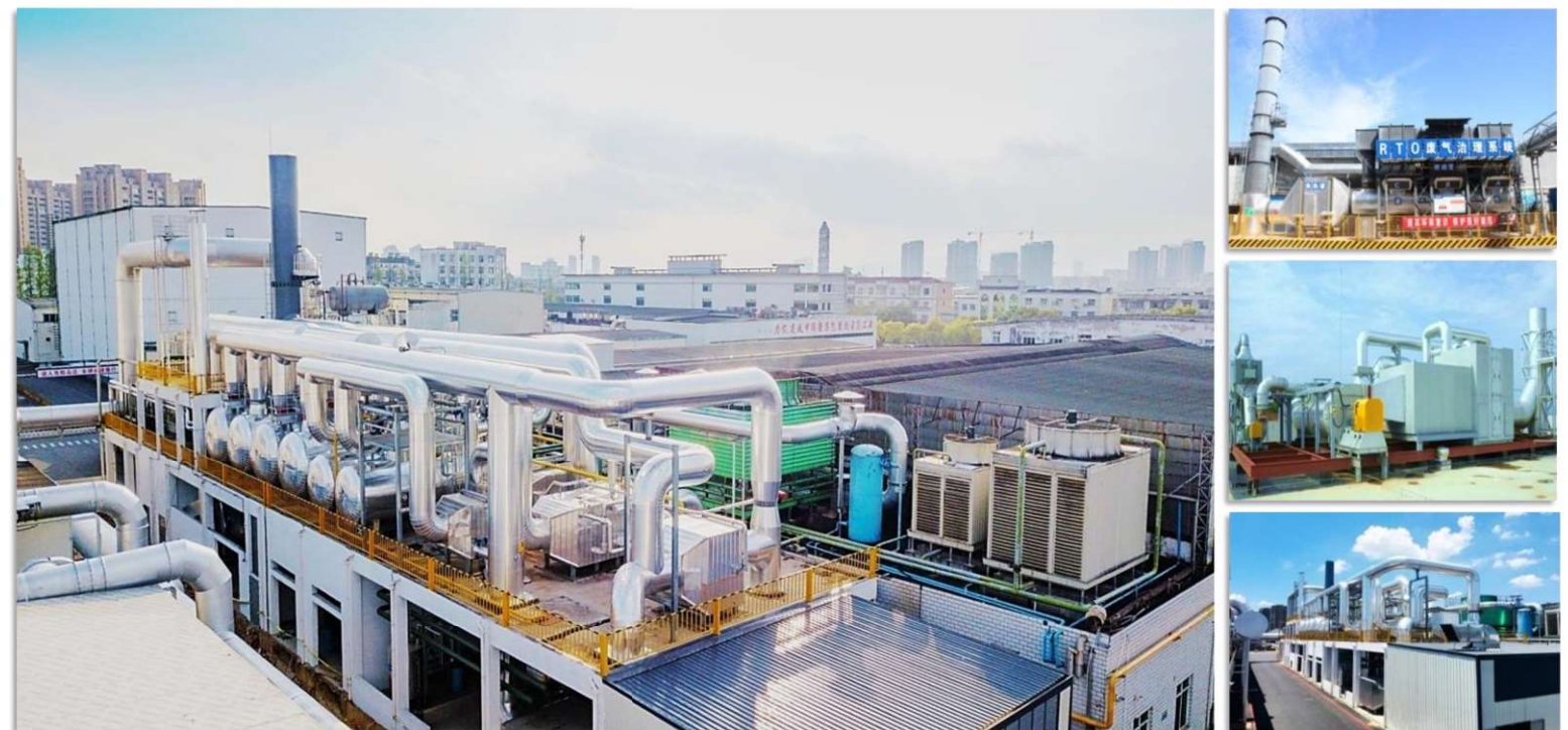
黄山永新溶剂回收废气治理项目
