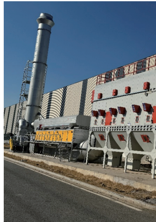
连云港东磁新建项目废气治理设施建设完成
