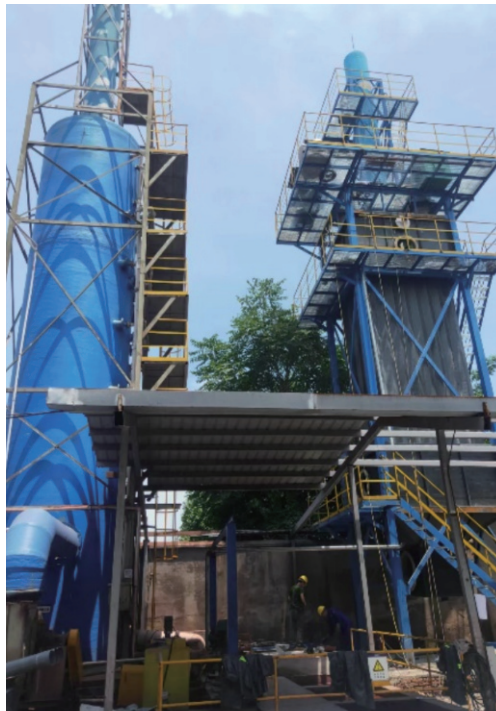
横店东磁永磁预烧料生产线老污染源废气处理设施提升改造项目完成
