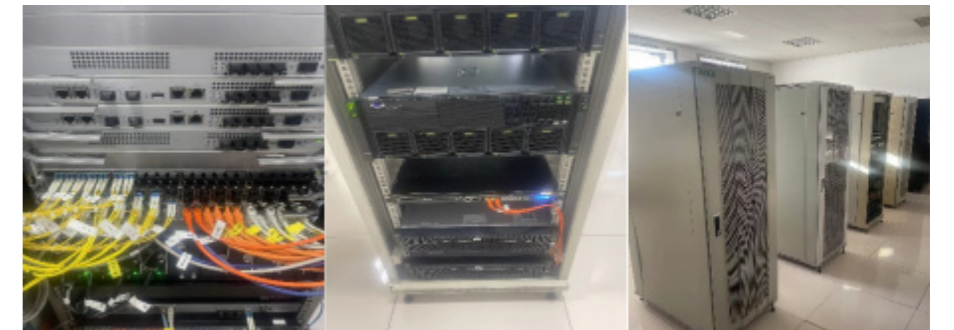
机房设备设施
