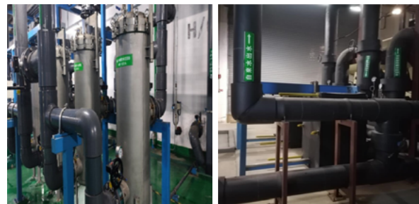
上海天马（左）武汉天马（右）无机回收水系统设备
