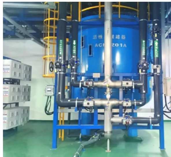
臭氧废水回收处理系统
