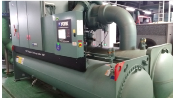
磁悬浮冰机节能改造项目
