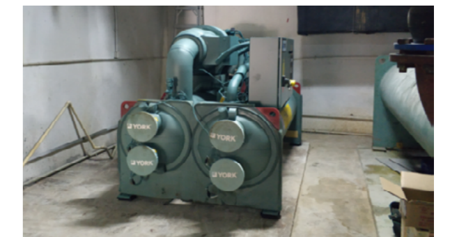
螺杆机热泵项目
