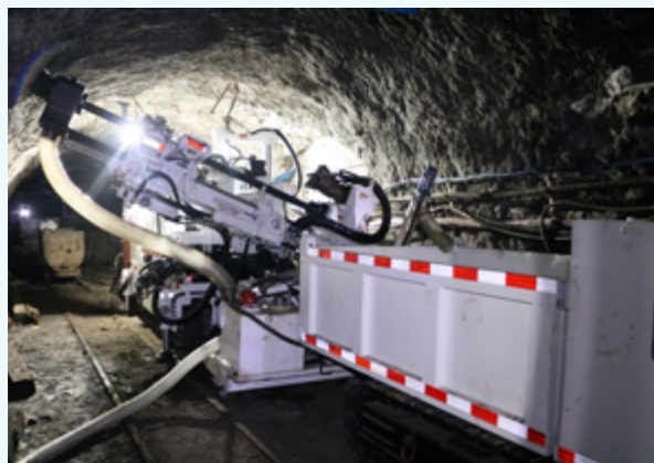
国内首套煤矿井下自动钻孔作业线成套技术装备
