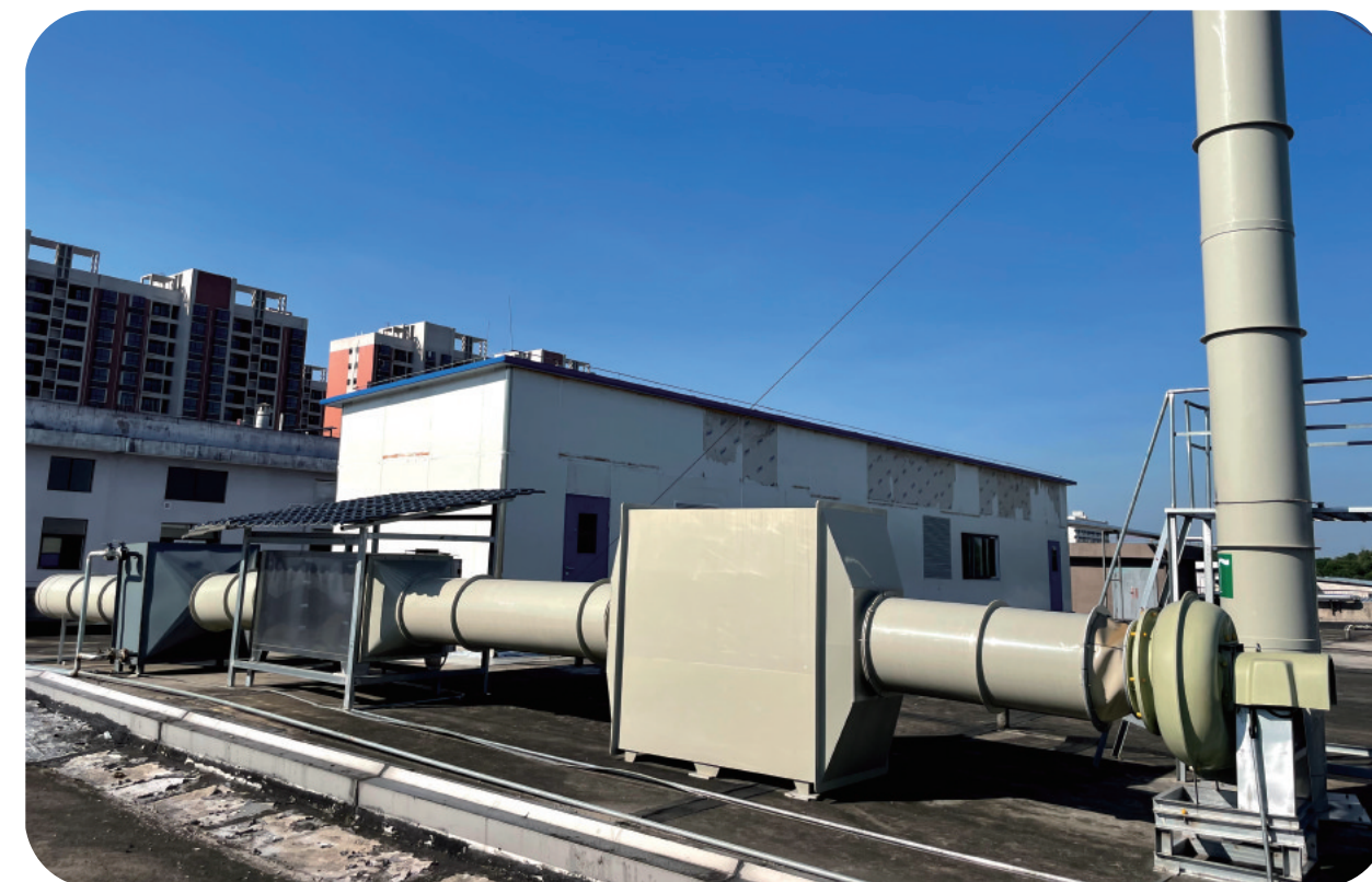
◆ 湘中制药中试车间废气收集处理设施
