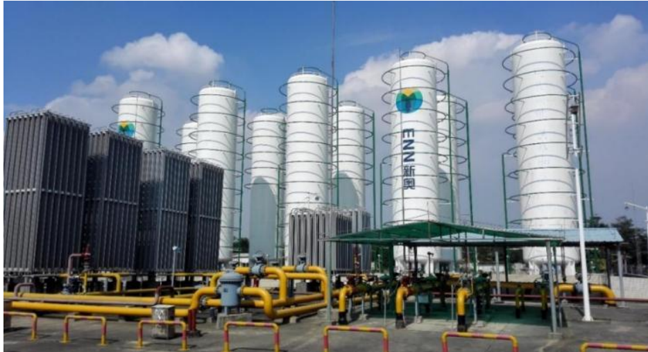
公司天然气厂站
