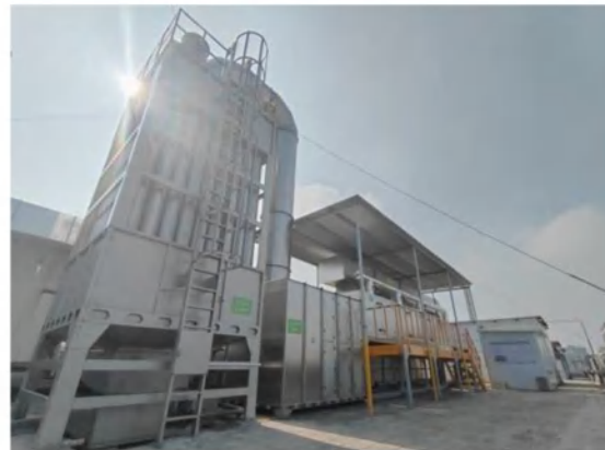
图：三水东电分公司新治理设施
