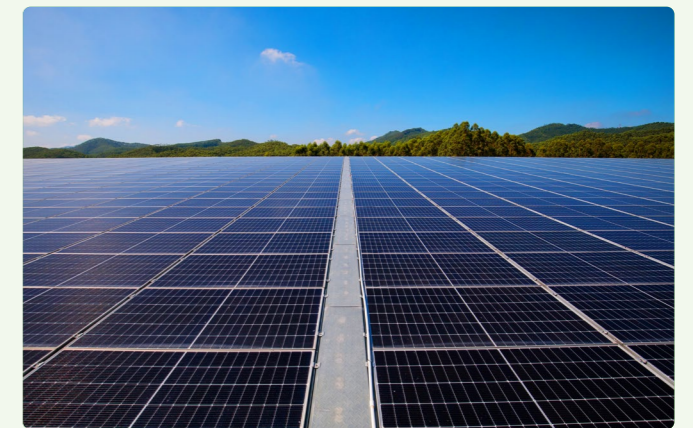
永航新材料 BIPV 光伏项目
