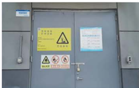
危废暂存间标识
