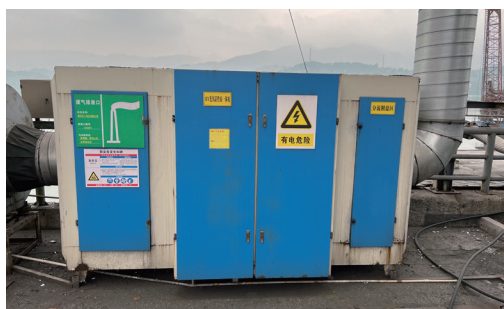
► 化工码头沥青平台尾气回收装置
