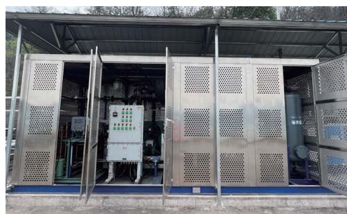
► 化工码头液化作业区尾气回收装置
