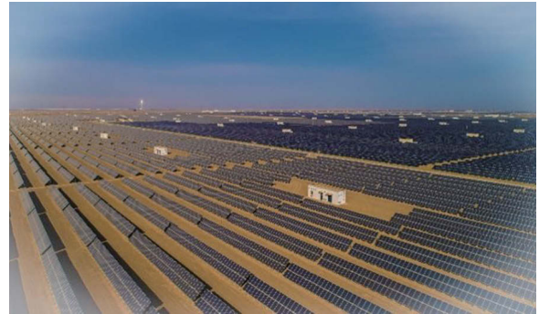
◆ 戈壁滩上风光好，敦煌市某光伏发电项目进入“加速跑道”
