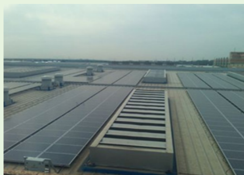
董家口基地光伏设施
