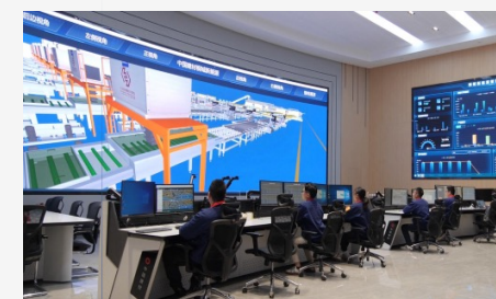
智慧控制中心实景图
