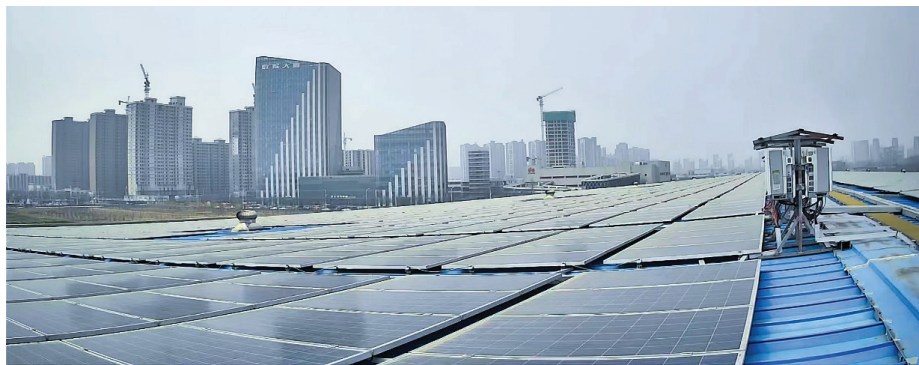
公司厂区内的光伏电站
