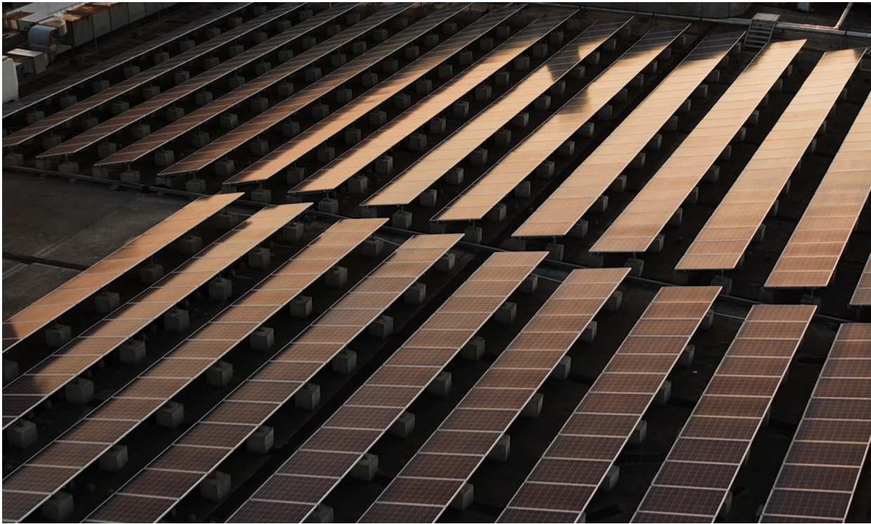
分布式光伏安装情况
