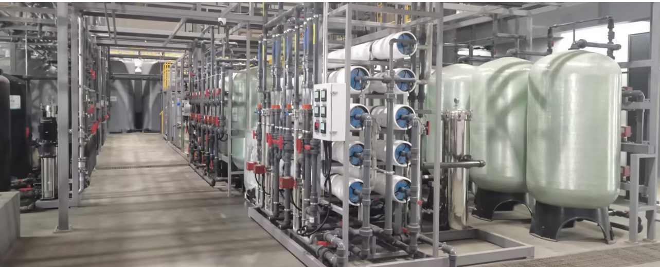
公司电镀废水处理系统
