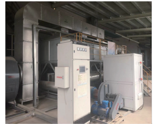
废气处理装置
