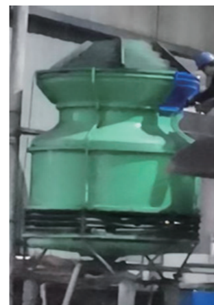
安装节水型冷却塔,降低生产过程中的水资源消耗
