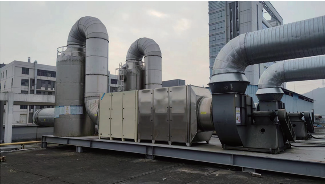
▲ 有机废气处理设施
