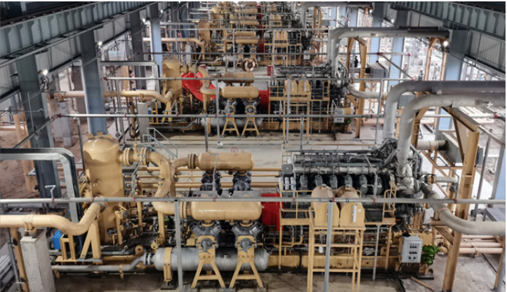
海外某项目天然气设备
