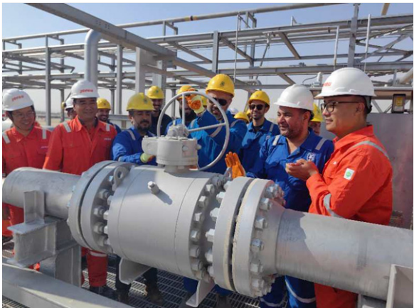
科威特北部侏罗纪生产设施 5 期项目设施
