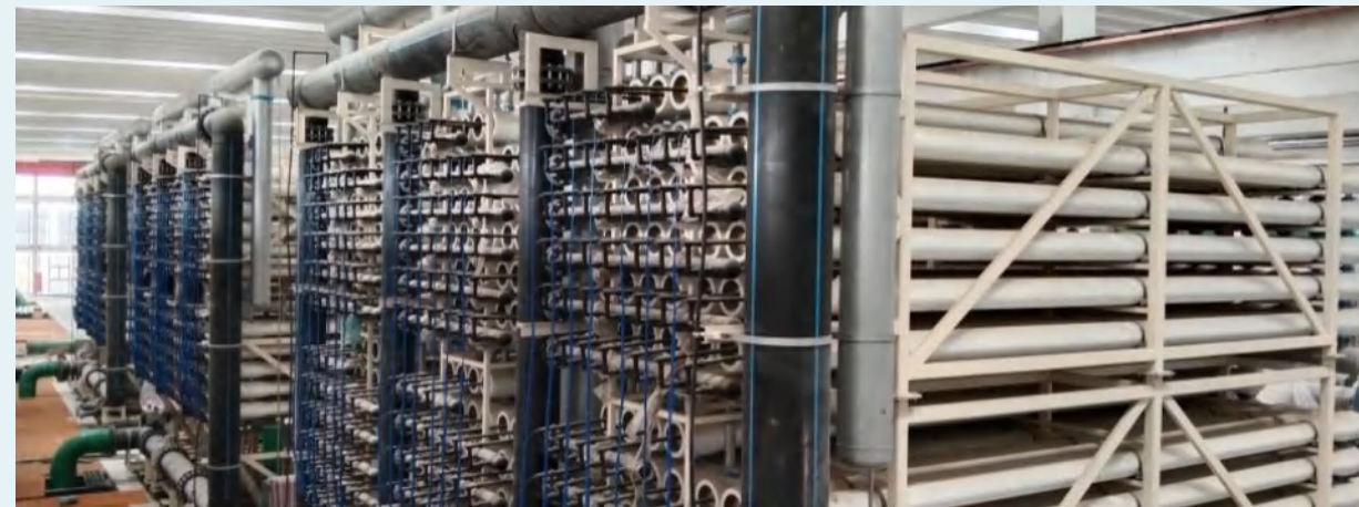
碧水源山东鲁北海水淡化工程
