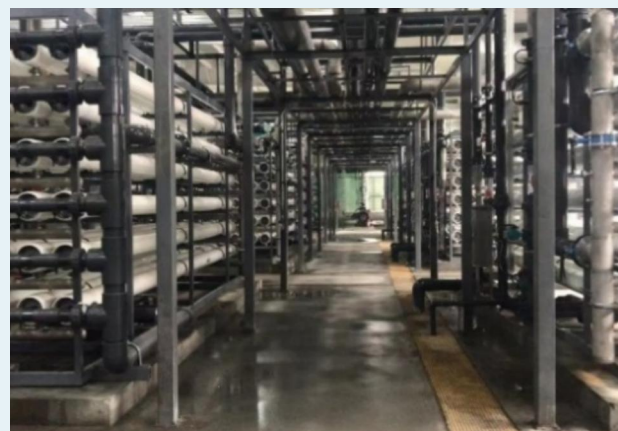
天合光能光伏淮安二期、三期超纯水系统设备集成项目
