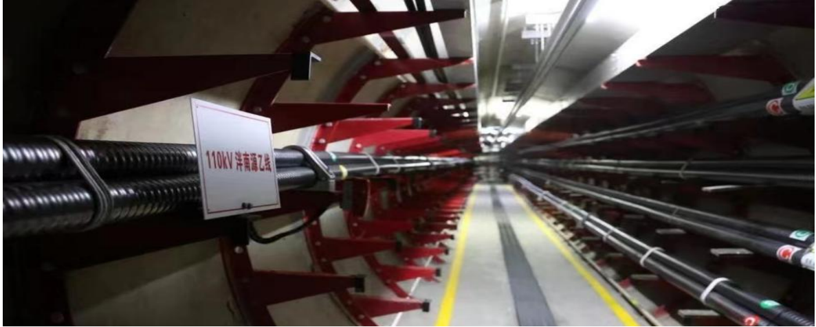
图：110kV 聚丙烯电缆线路
