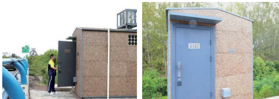
碳化隔离软木环保ETC门架机房
