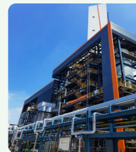
瀚蓝佛山绿色工业服务中心工程(南海)项目内危废处理设施
