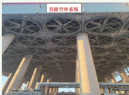
苏晋保德直接空冷系统
