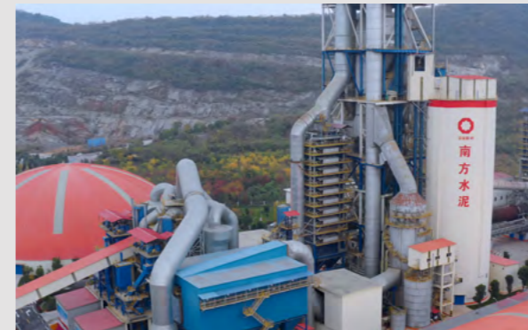
湖州南方水泥项目工业余热锅炉
