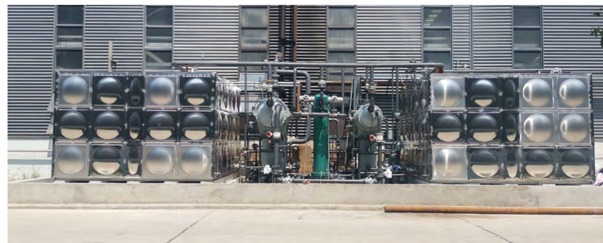
蒸压釜乏汽余热回收及储能项目
