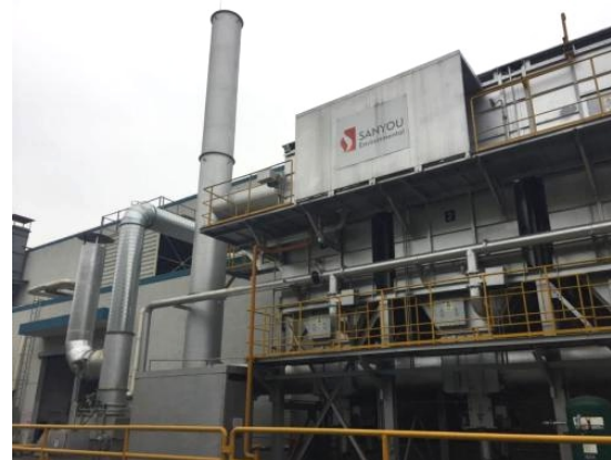
RTO蓄热式焚烧处理设施
