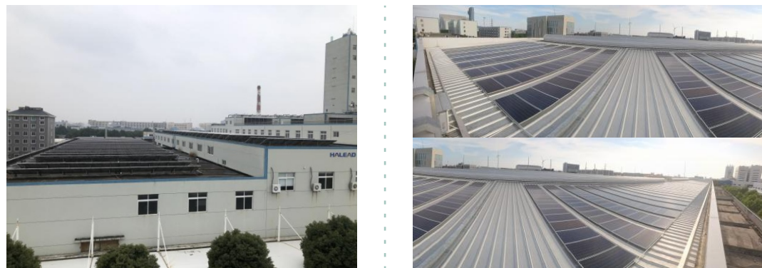
厂房屋顶太阳能板
