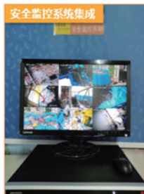
安全监控系统集成
