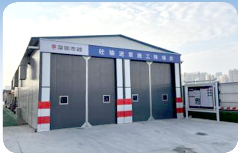
● 混凝土输送泵施工降噪房
