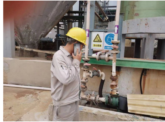
1. 设备管理员在巡检过程中发现盐酸储罐泄漏，立即通知管理员上报
