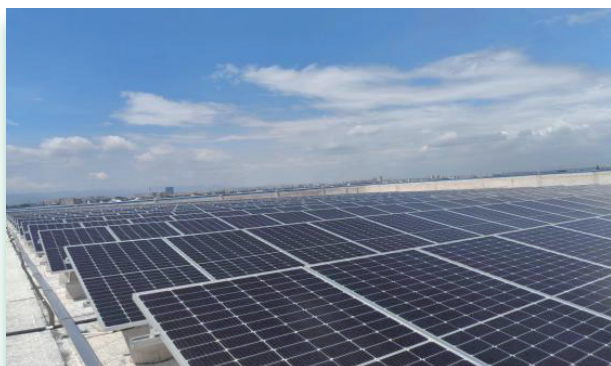
▲ 物产金义屋顶光伏
