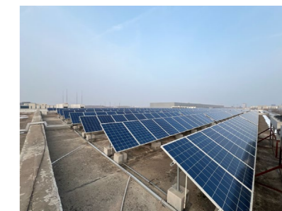
屋顶光伏现场图
