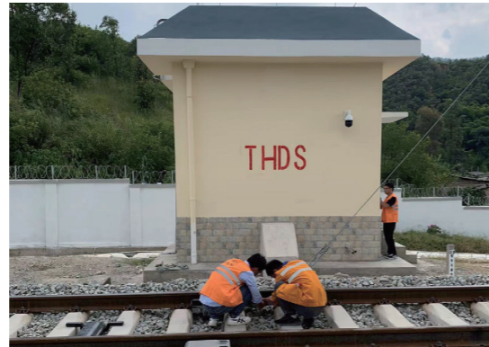
▲航天智装铁路车辆运行安全检测装备走向国门，为“一带一路”贡献航天力量。图为公司中老铁路设备安装调试一线现场。
